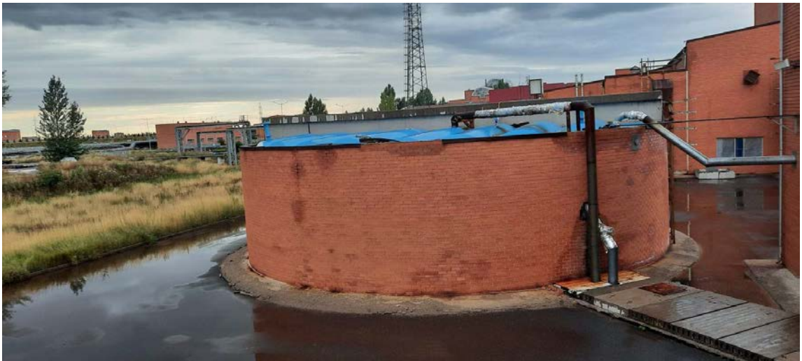
Фото 31 - Блок уплотнения сырого осадка
