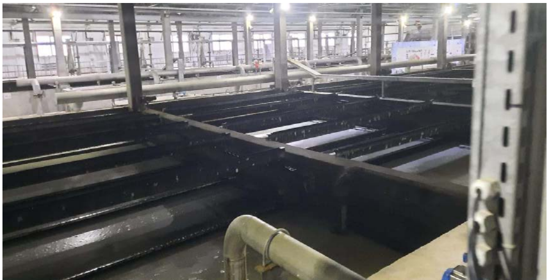
Фото 26 - Флотофильтры в цехе доочистки
