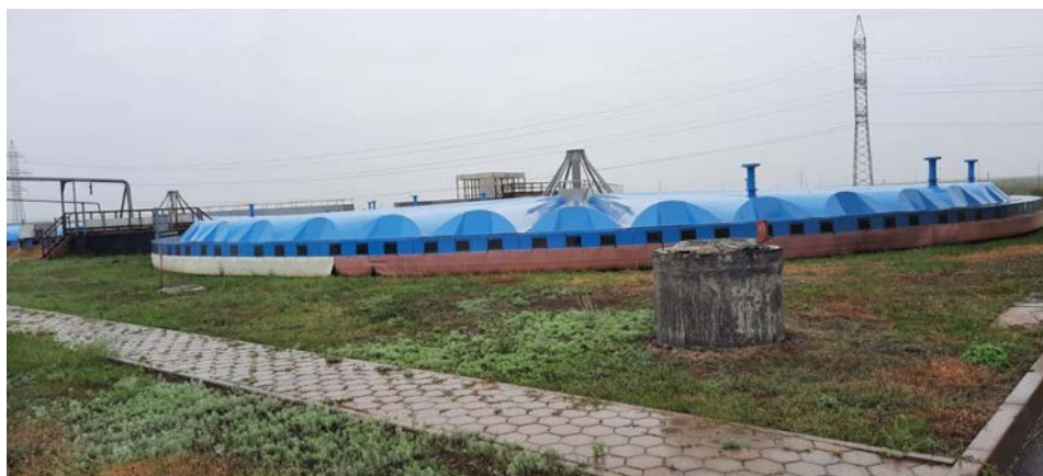
Фото 18 - Первичные отстойники 2 очереди – закрытые
