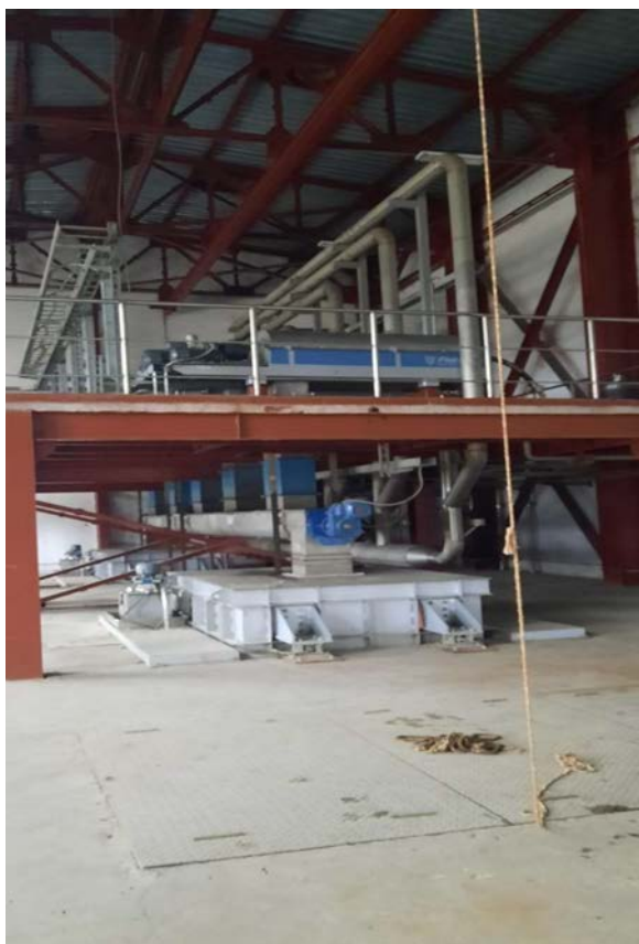
Фото 6 - Центрифуги мехобезвоживания осадка 2 очереди
