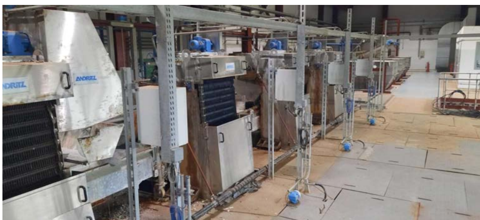
Фото 11 - Решетки тонкой очистки
