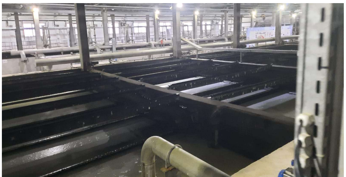
Фото 26 - Флотофильтры в цехе доочистки
