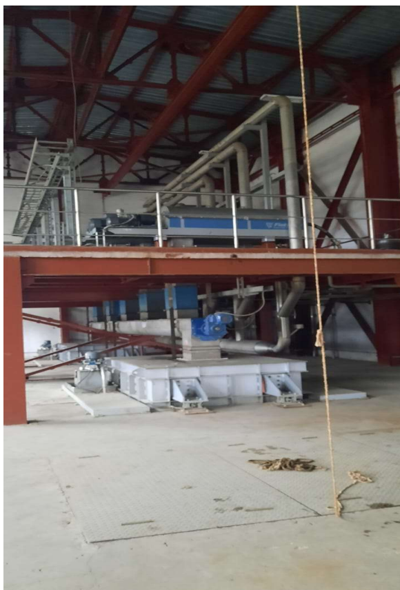
Фото 6 - Центрифуги мехобезвоживания осадка 2 очереди
