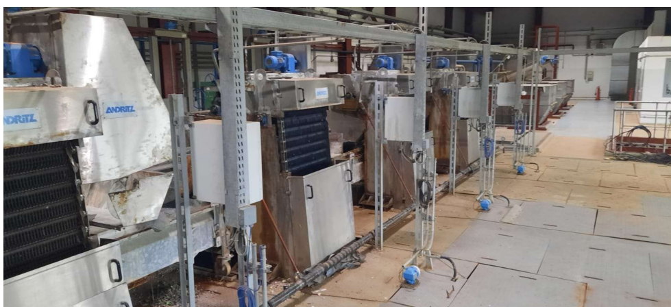
Фото 11 - Решетки тонкой очистки
