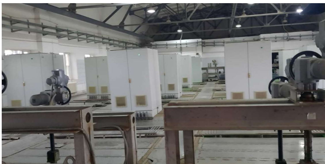
Фото 29 - Оборудование в Цехе УФ-обеззараживания
