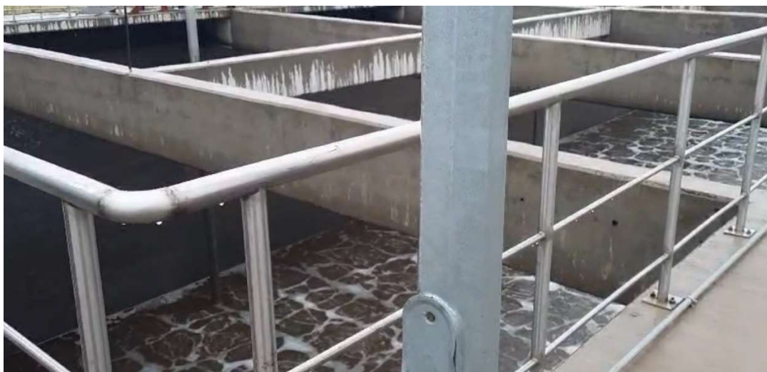
Фото 22 - Аэротенк 1 очереди на промывке
