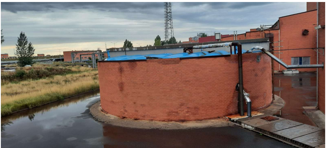
Фото 31 - Блок уплотнения сырого осадка
