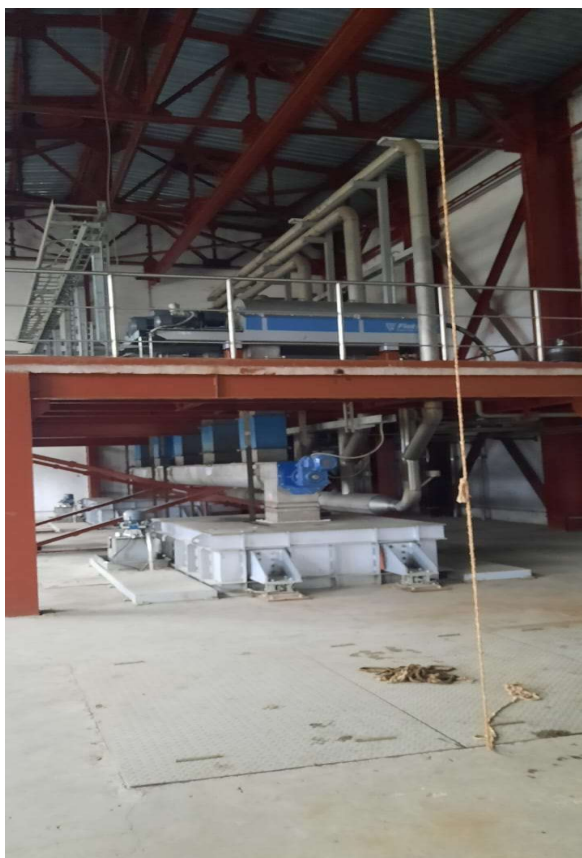
Фото 6 - Центрифуги мехобезвоживания осадка 2 очереди
