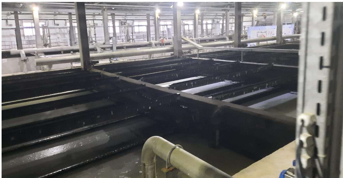
Фото 26 - Флотофильтры в цехе доочистки
