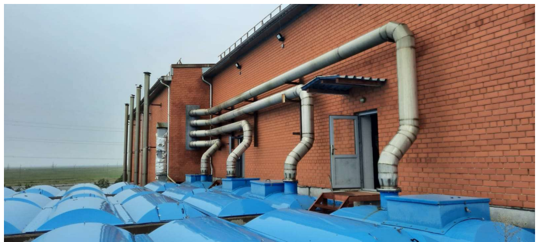
Фото 15 - Система газоочистки от песколовок
